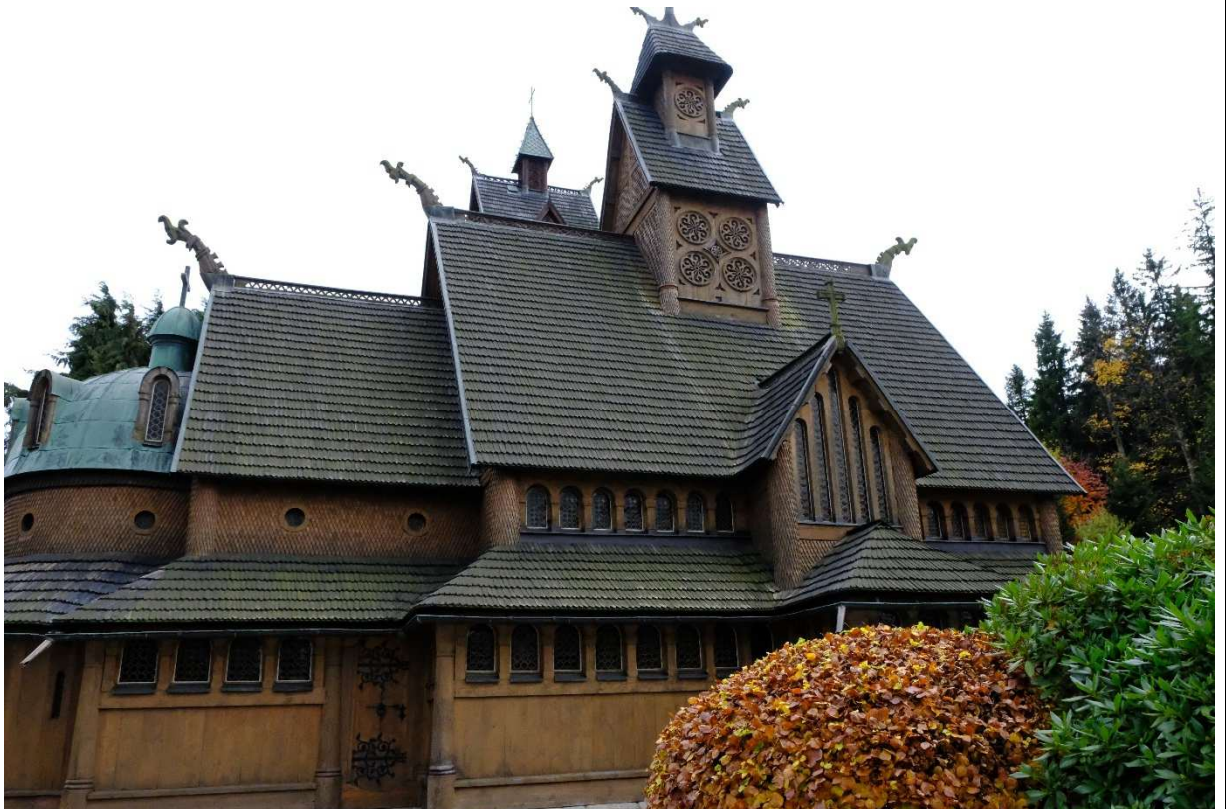
Ryc. 40. Elewacja północna pokrycie dachowe pokryte żelonym nalotem.
