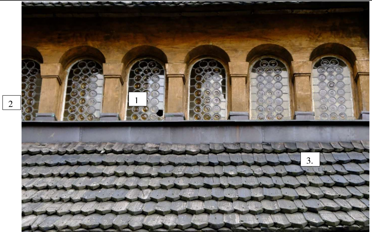
Ryc. 27. Elewacja południowa ubytek w s ł ekleniu (1), patyna (2), ubytek (3).
