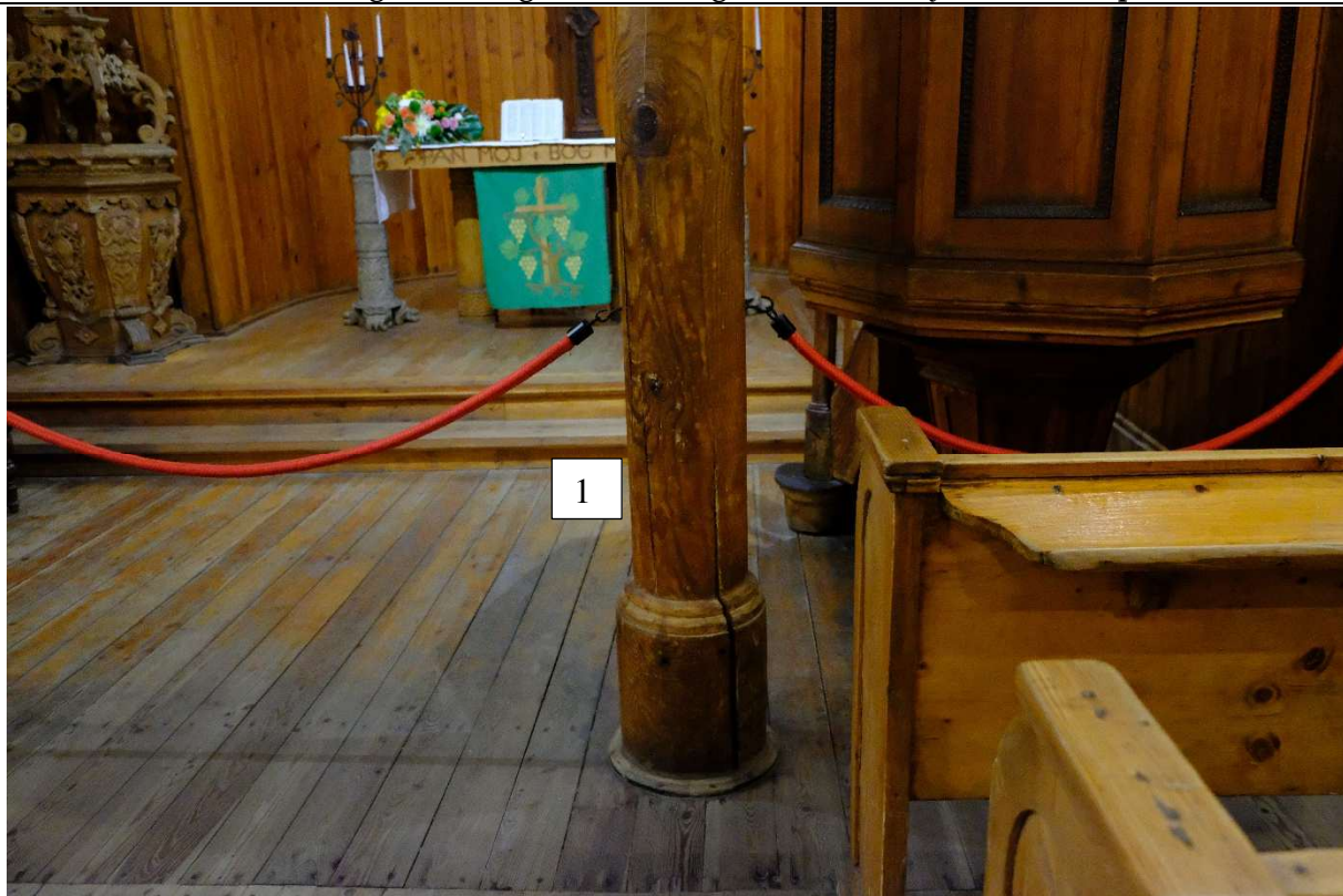
Ryc. 50. Wnętrze kościoła pęknięcie (1).
