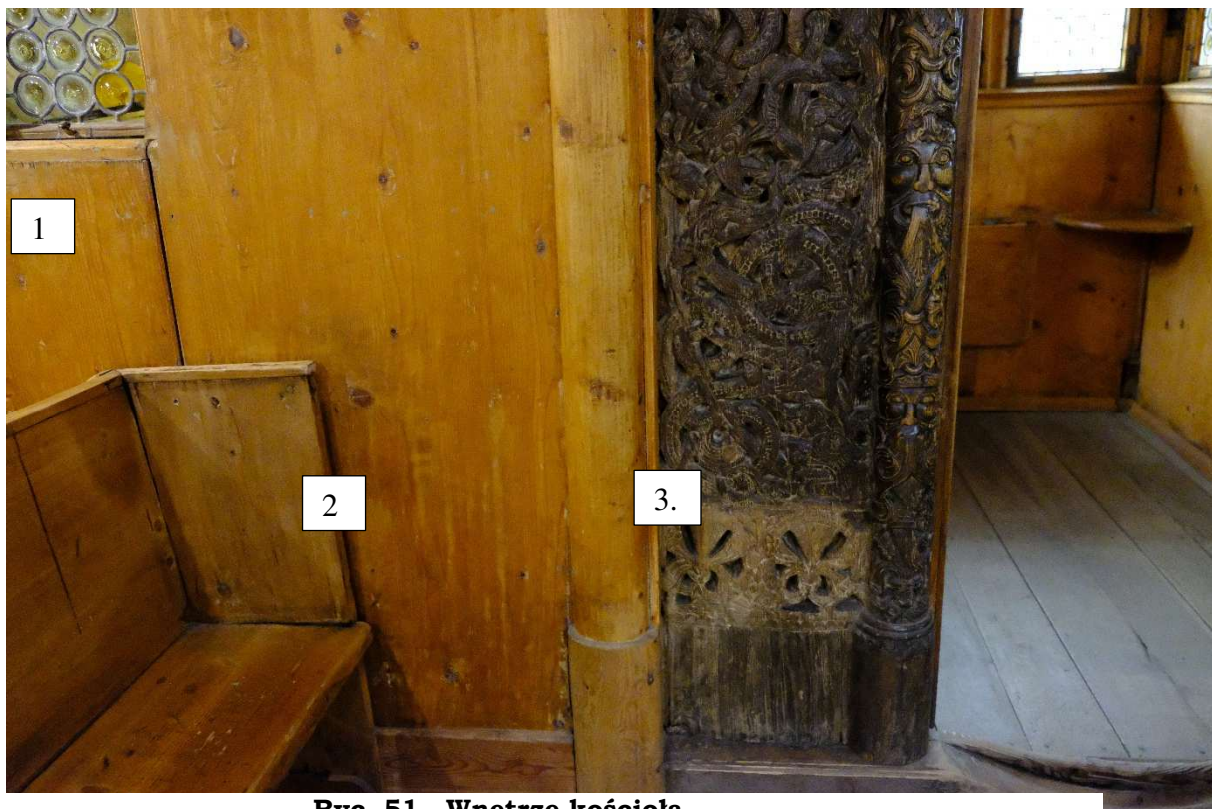
Ryc. 51. Wnętrze kościoła ściana (1), zabrudzenia (2), przetarcia (3).
