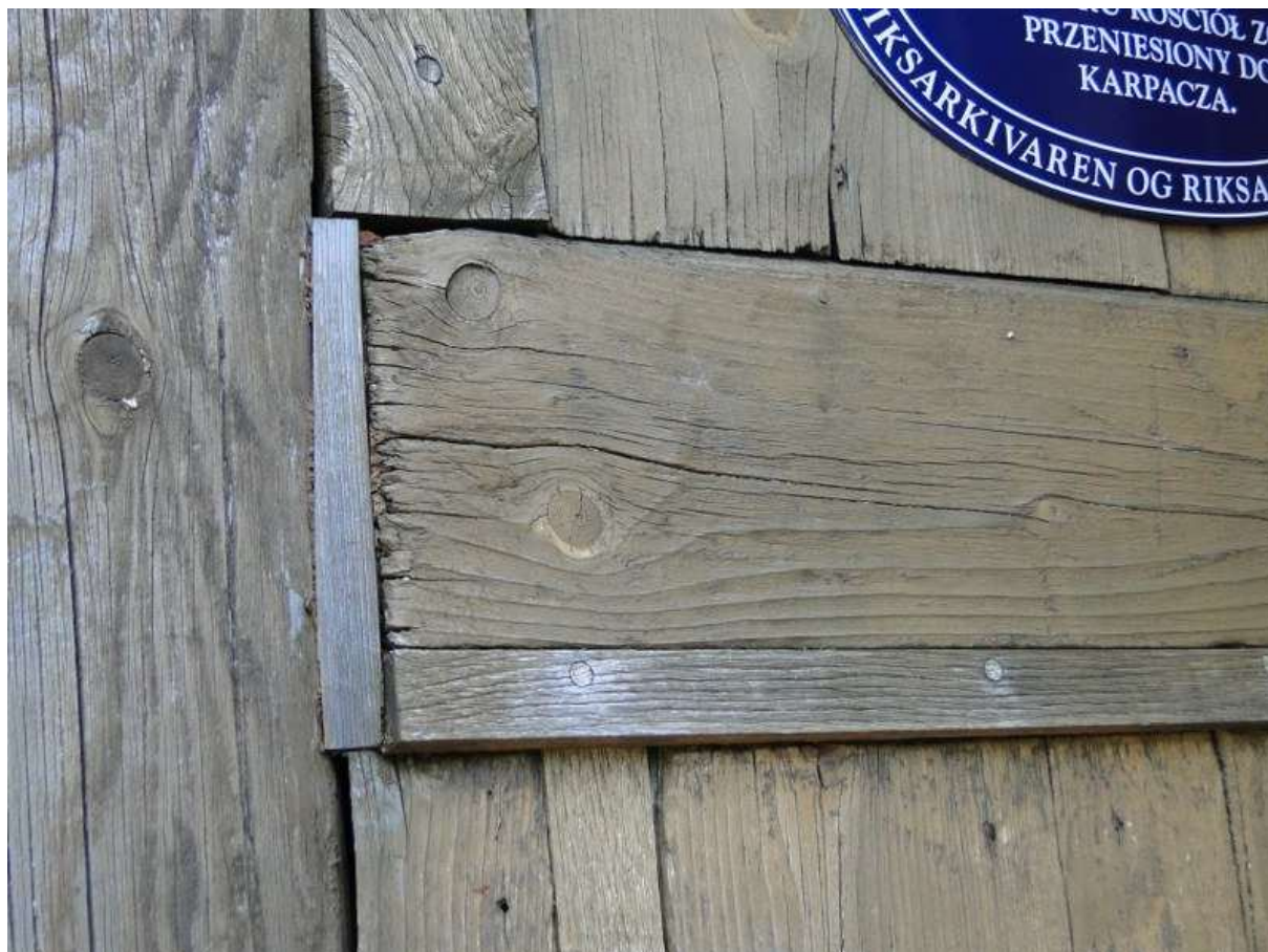
Ryc. 20. Elewacja zachodnia: wtórne uzupełnienia, szczeliny, pęknięcia.
